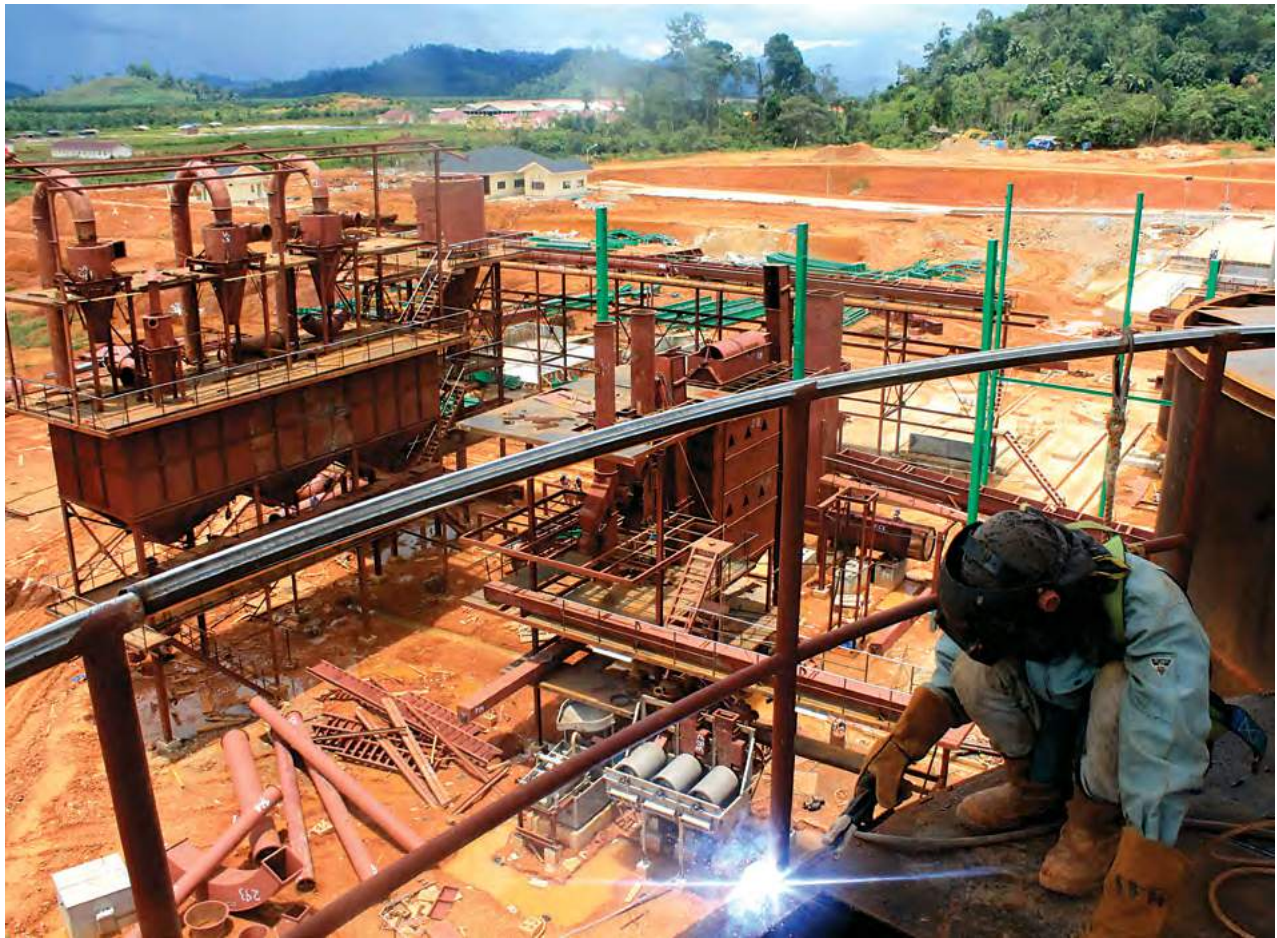
Kemajuan pabrik skala penuh di Perkebunan Kalimantan Barat kami pada 2015. Pabrik ini akan selesai pada akhir 2016.
